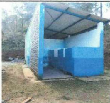
Foto 9: Circulación estructura metal y lamina troquelada de aluzinc calibre 26, area abierta en sanitario de mujeres.
