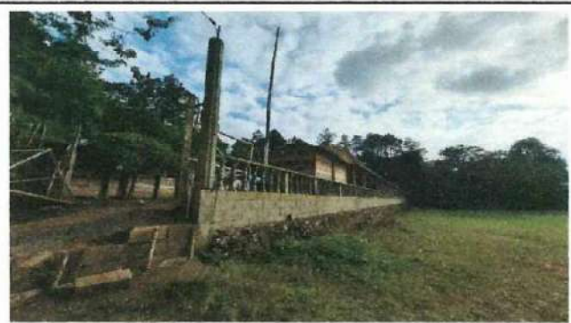
Foto 4: Cernido en pared de block area perimetral del establecimiento educativo.
